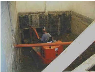
Die Erdarbeiten gehen innerhalb des Gebäudes bis zu 4 m in die Tiefe.
