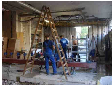
Unsere Schule wird an das Fernwärmenetz des Landkreises angeschlossen.
